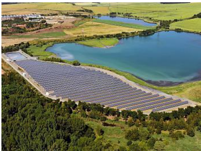
Letecký pohled na sluneční elektrárnu. Autor: Actherm
